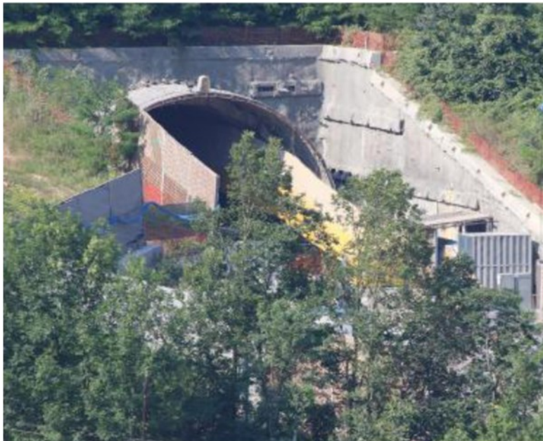
Il cantiere della Pedemontana posto sotto sequestro dalla procura.
