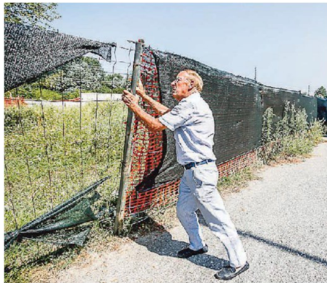
Sopra il cantiere di via Olimpia, sotto le recinzioni rotte
