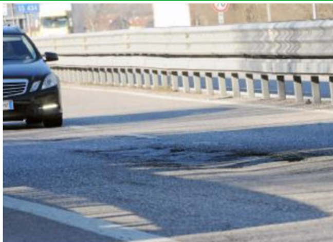
Una buca pericolosa in prossimità dello svincolo di Legnago Nord
