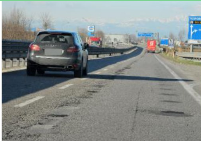
Un tratto dissestato di superstrada all'altezza di Palesella DIENNEFOTO
