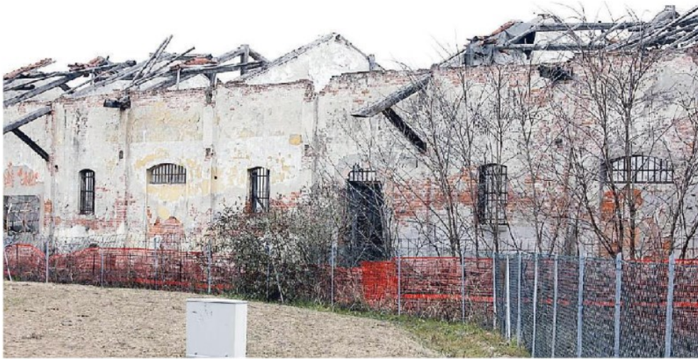
Strutture fatiscenti: nei centri urbani potrebbe diventare ancora più complicato intervenire
