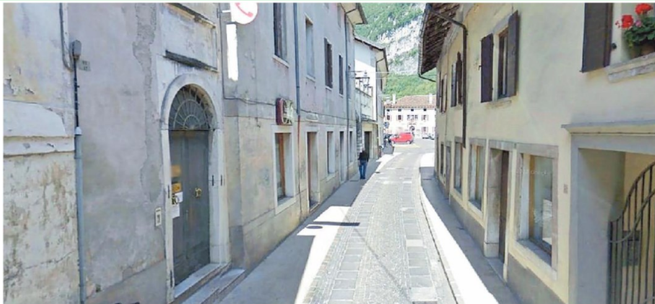
Uno scorcio del centro di Fonzaso: la pavimentazione è soggetta a problemi
