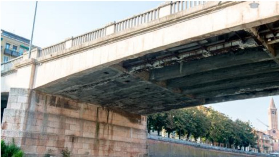
Ponte Nuovo presenta alcuni punti che necessitano di un restauro: via ai lavori tra meno di un anno
